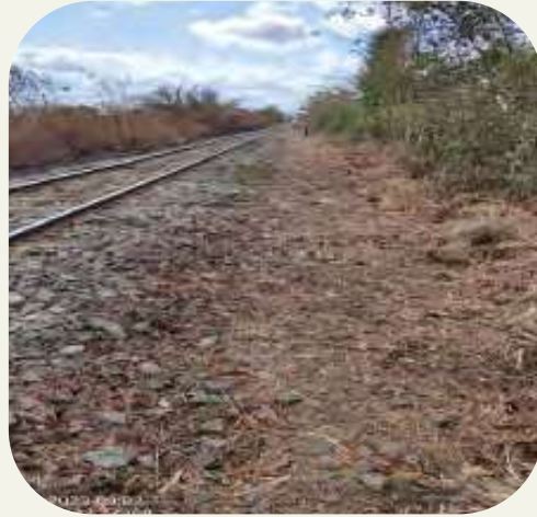
Capina na via permanente para evitar foco de incêndio no período de seca.
