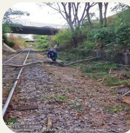
Remoção de tronco que estava obstruindo a passagem do VLT.
