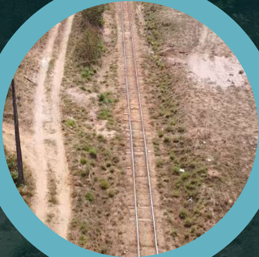
Dormentes Deterioradas e/ou inexistentes
