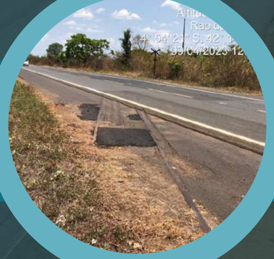
Trilhos e PNs Trilhos ausente em trechos Passagens em nível deterioradas
