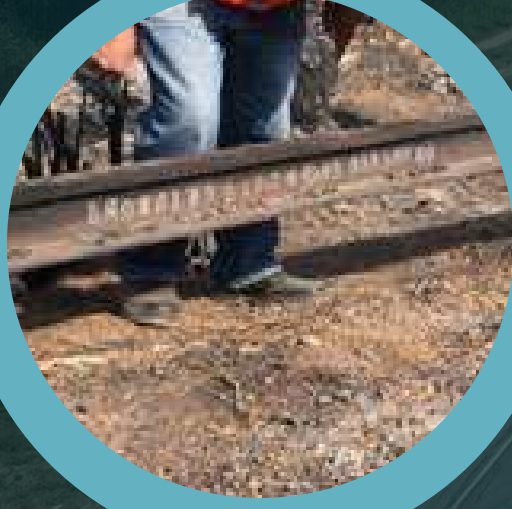
Lastro e sublastro Inexistente e/ou com baixa resistência mecânica (constatado pelo SPT+CBR)
