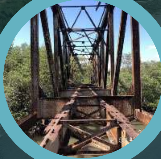
Pontes Enferrujadas (metálicas) com armadura exposta (concreto) e deterioradas
