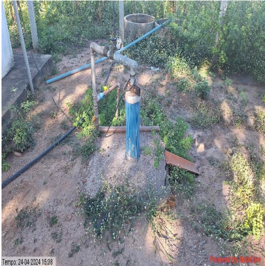
Foto 01: Poço em pleno funcionamento que será utilizado no SAA;
